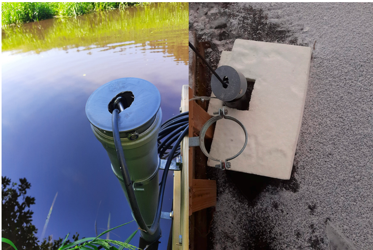
Kuva 10. Talvipakkasten ulkopuolella jatkuvatoimiset mittauslaitteistot asennettiin muoviputkiin (vasemmalla). Olkkalanjoella mittausta pidettiin yllä myös talviaikana, jolloin mittari on asennettu jääpatsaan alapuolelle. Sondin yläpuolella olevan vesimassan jäätyminen oli mahdollista välttää asentamalla eristelevy (LUVY / Erkka Laitinen).
